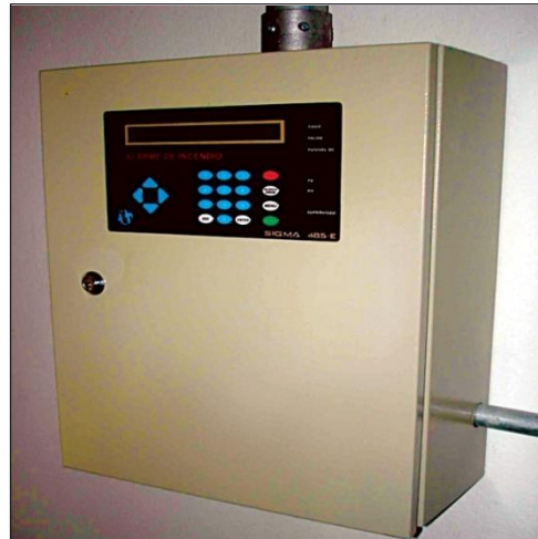
Figura 50: Central de alarme de incêndio
