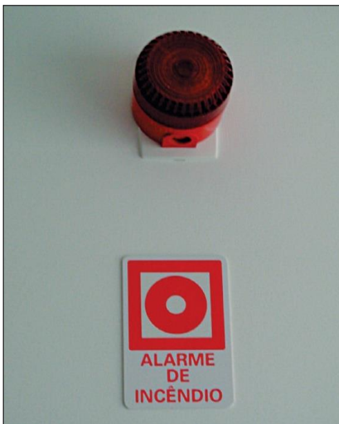
Figura 49: Detalhe de sirene.
