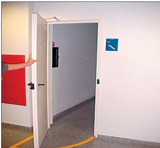
Figura 42: PCF em corredor.
