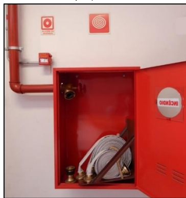
Figura 55: Detalhe de hidrante.
